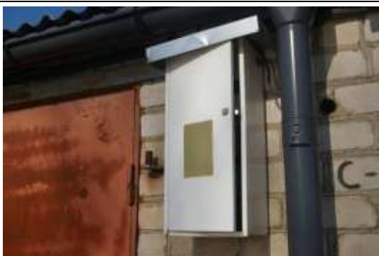
Būve ar kadastra apzīmējumu 1700 023 0078 005, garāža C-2, elektroapgāde
